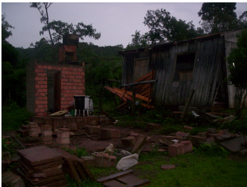
Foto 06 – Vendaval 2009 – Destruição total de Casa- Rua Emilio Geraldo da Silva
