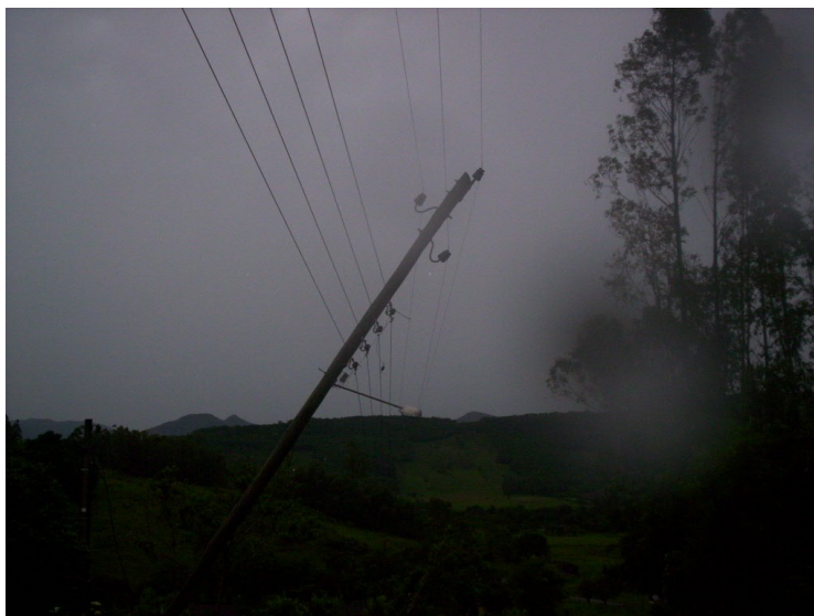
Foto 07 Vendaval 2009 – Dano em rede de distribuição elétrica
