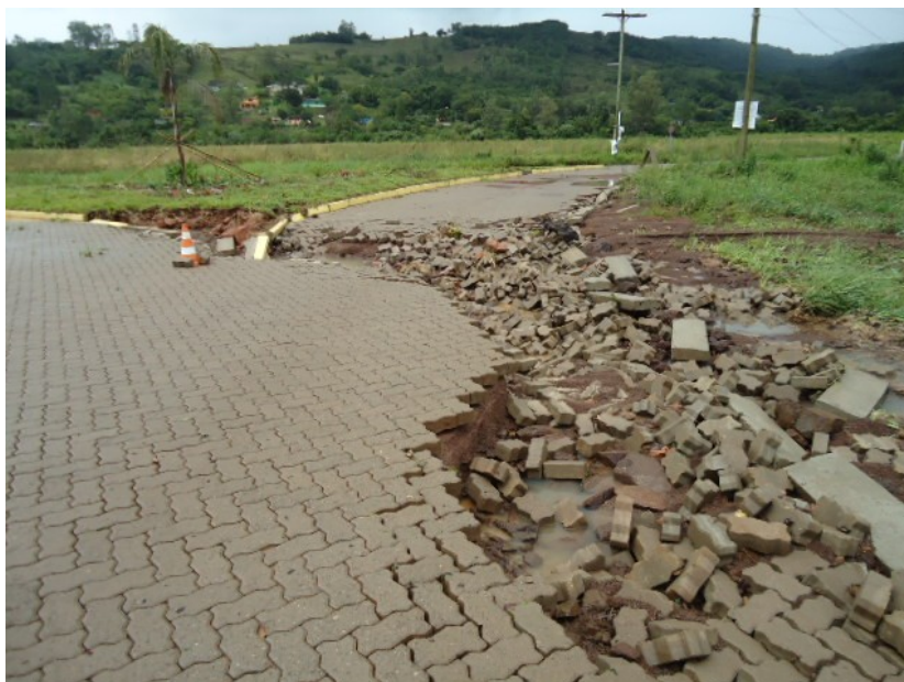
Foto 09 – Inundação 2012 – Dano ao pavimento – Rótula Av. Arno Von Saltiel
