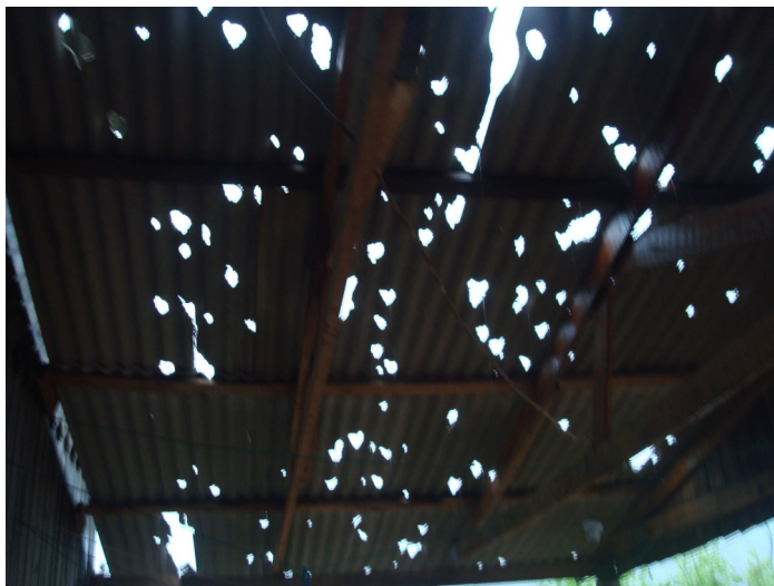
Foto 13 – Granizo 2015 – Telhado danificado por ação das pedras
