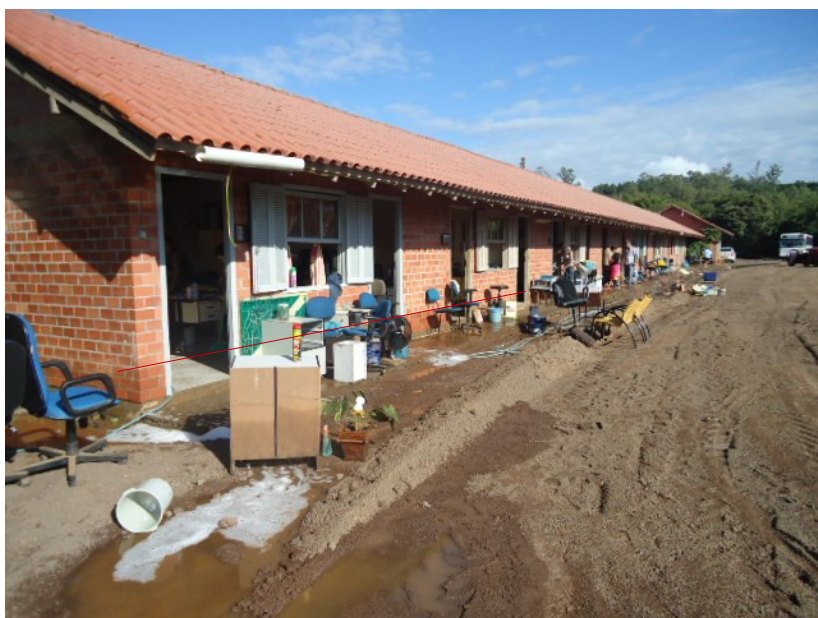
Foto 10 – Inundação 2012 - Sede da Prefeitura após ser invadida pela água (Na linha vermelha marca aproximada do nível da água).
