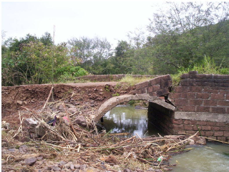
Foto 01 – Enxurrada 2008 – Destruição de ponte sobre o arroio Vila Nova – Vila Nova / Divinéia
