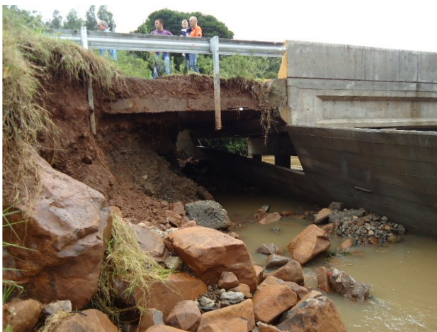
Foto 08 – Inundação 2012 – Supressão de material sob a cabeceira da ponte do Didi – Centro
